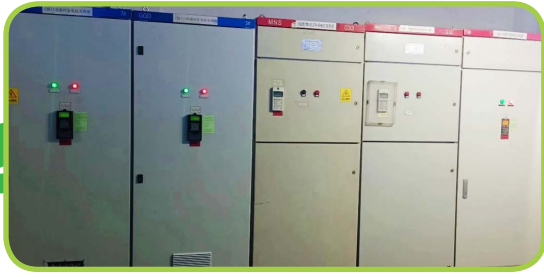
循環泵電機技改變頻器
